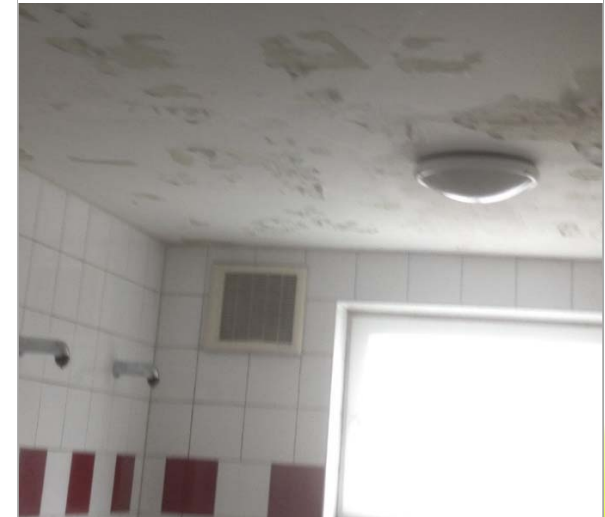
Bsp.: Anlage mit zu kleiner Lüftungsanlage
